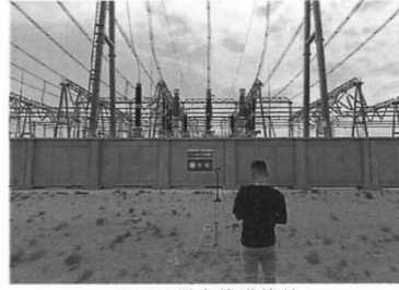
220kV 贡中线进线处
