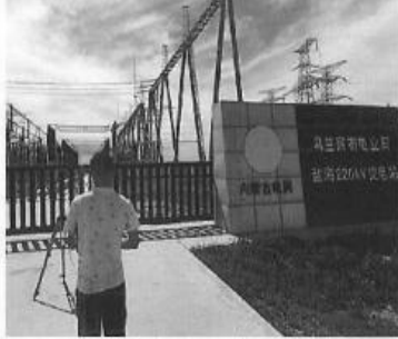
盐海 220kV 变东
