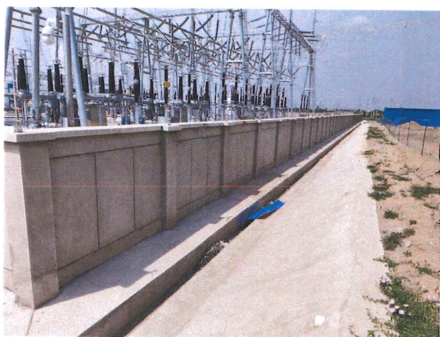
禄安变北侧围墙
