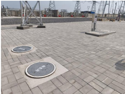
集水池和化粪池
